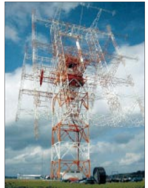
Drehstandantenne des KWZ 1
